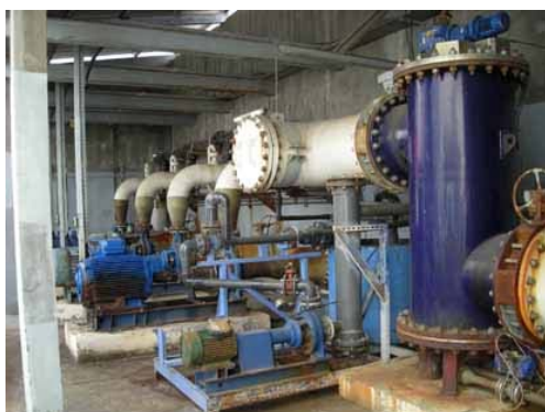
Les pompes d'alimentation
