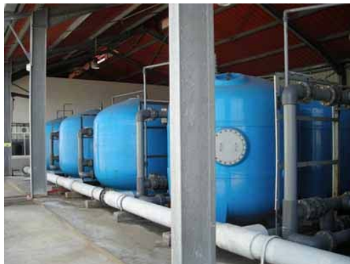
Les filtres à sable
