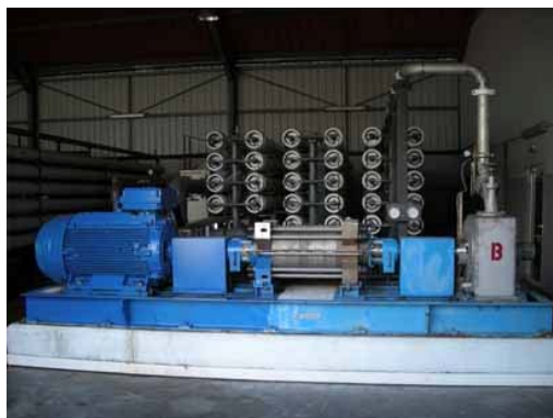
Les pompes haute pression. A gauche le moteur électrique, au centre la pompe centrifuge multi étages, à droite la turbine Pelton. Derrière, les tubes contenant les membranes pour l'osmose.
