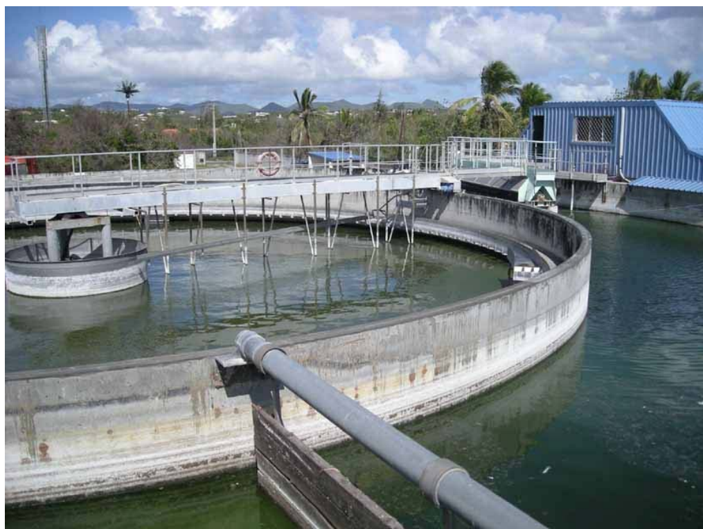
La station d'épuration de la pointe des Canonnières. En panne depuis le passage du cyclone Omar (problèmes électroniques et électriques) elle sera à nouveau en service en juillet.
